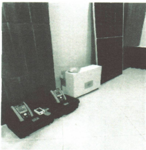
Figura 3: Modulo, inversor e equipamentos de comissionamento.
