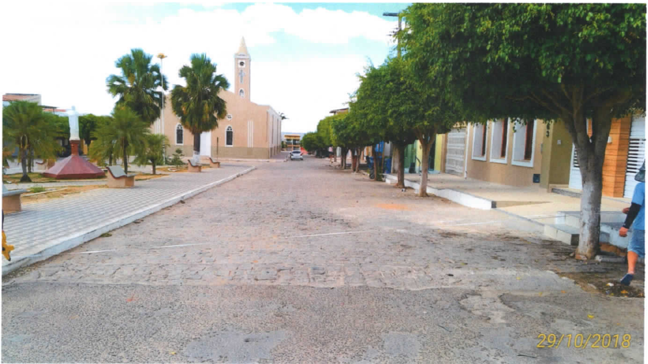
OBSERVAÇÃO: TRECHOS 03 E 02
